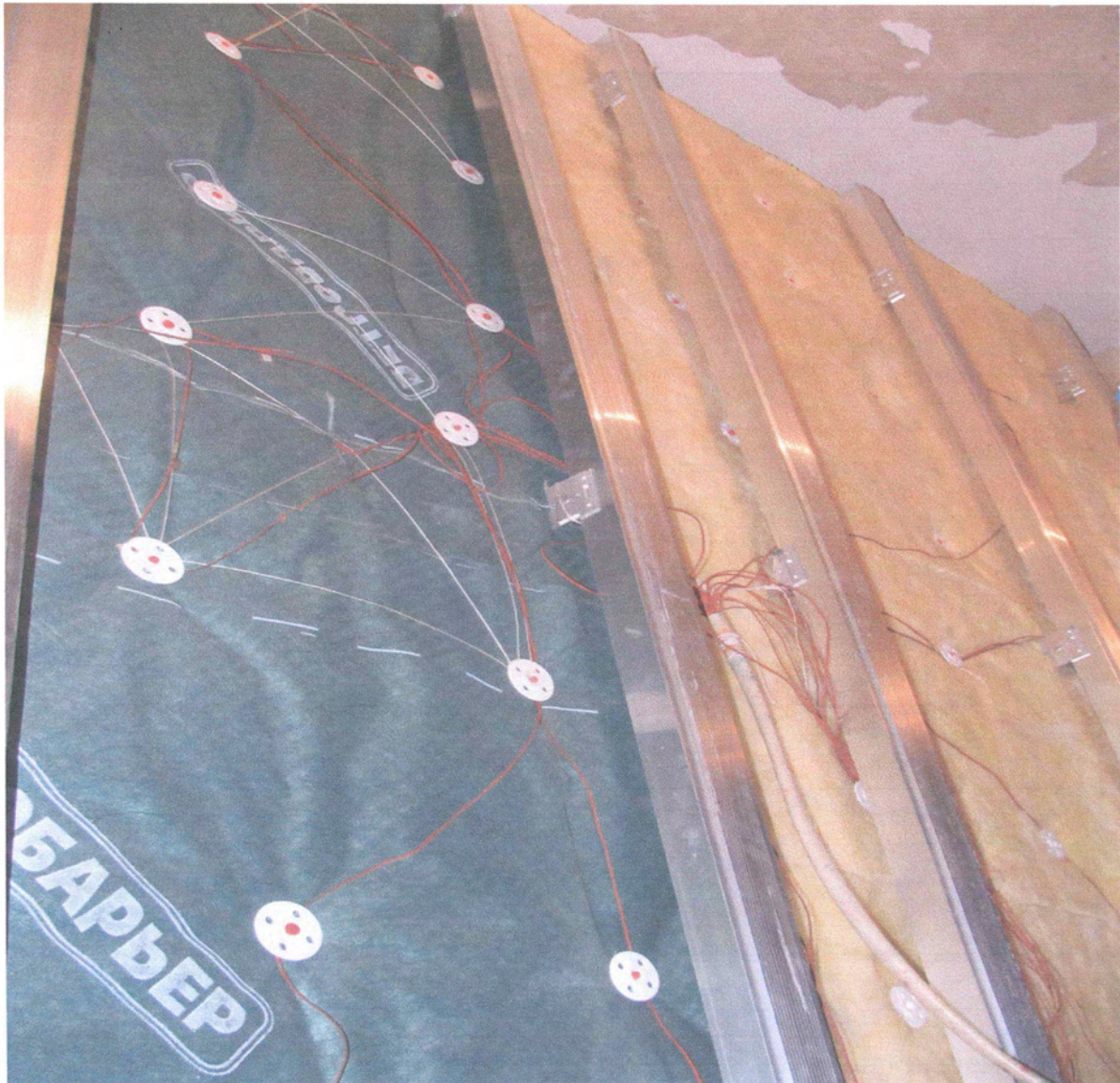
Рис.1.5 – Зовнішній вигляд дослідних конструкцій з утеплювачем із плит із скляної вати з повітрогідрозахисним мембранним шаром (зразок № 4) та без мембранного шару (зразок №3) під час їх монтажу.
